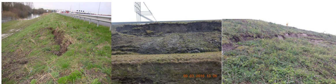
Foto: Afschuiving van talud.
