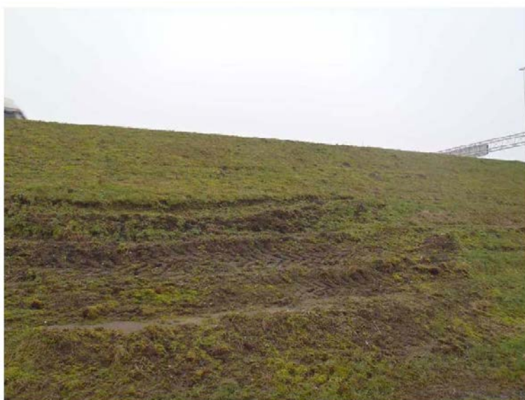
Foto: Maaischade aan afdeklaag.
